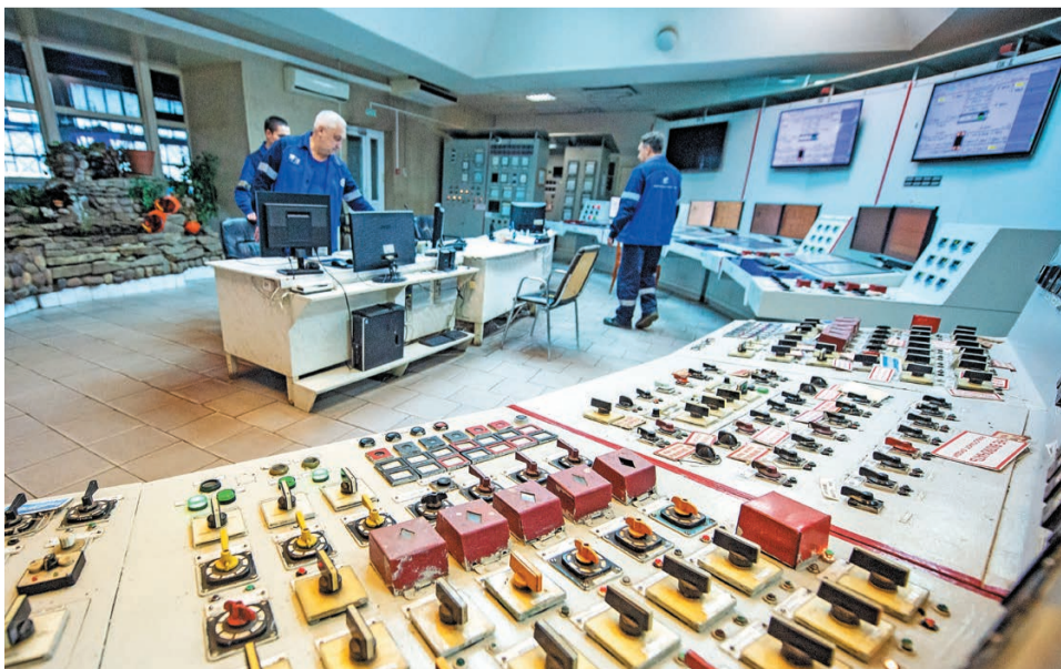
Машинисты теплового цита управления № 4 за ведением режима выработки электроэнергии и подачи тепла на ООО «Газпром нефтехим Салават»
