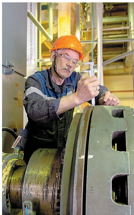
Замер зазора пневматической муфты
