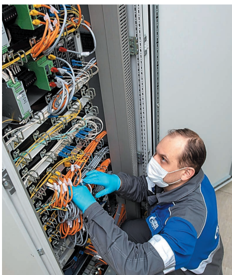
Проверка работы оборудования АСУТП на установке производства водорода
