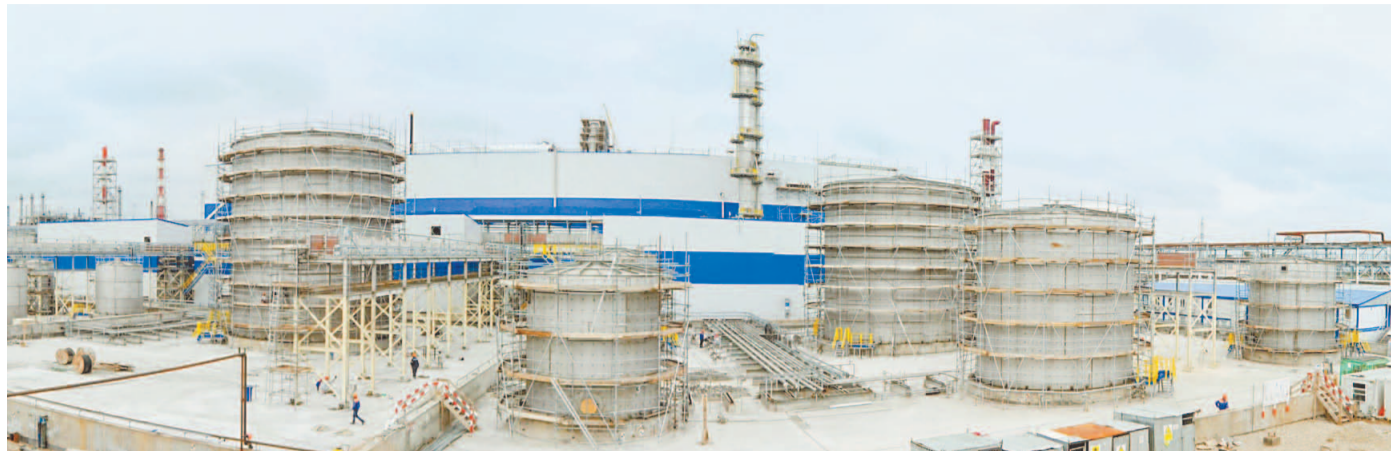
Строительство производства акриловой кислоты завершается, а в это время прорабатываются вопросы сбыта будущей продукции
