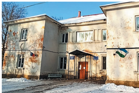
Так выглядел детский сад до ремонта...
