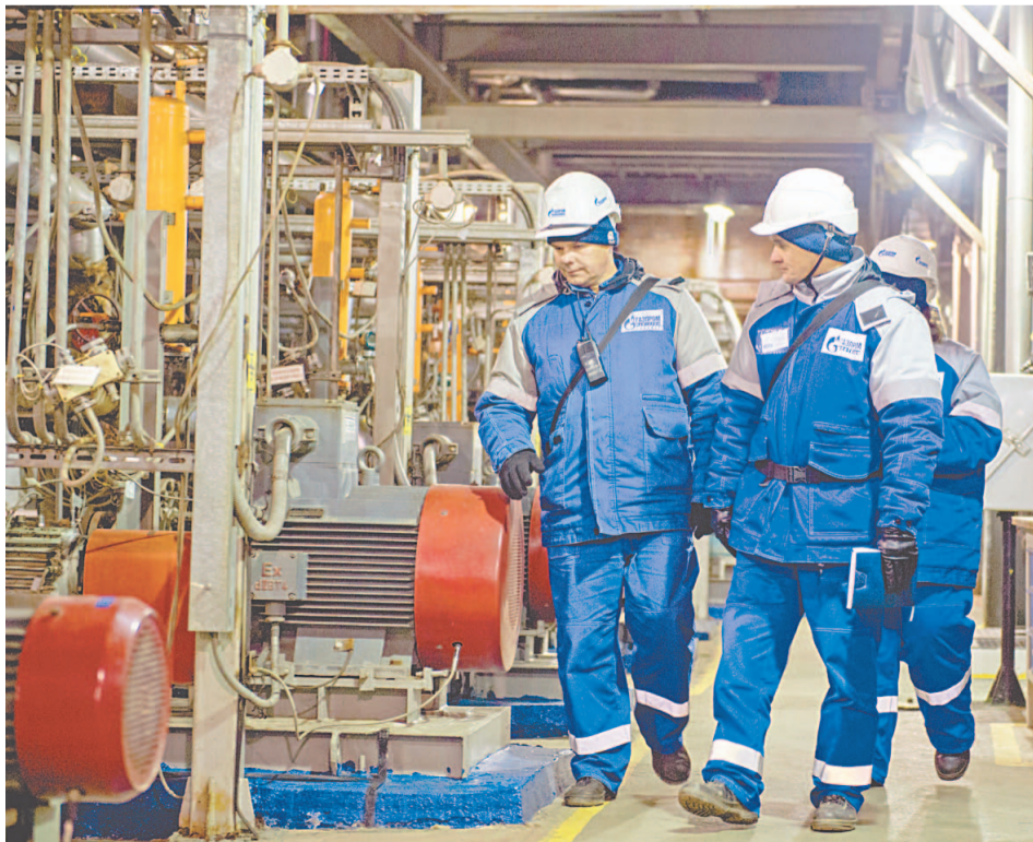
Оборудование под надежным присмотром
