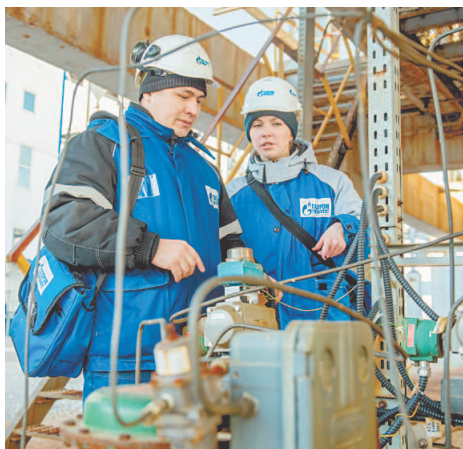
Во время обхода нужно тщательно проверить, что трубы и механизмы работают как часы
