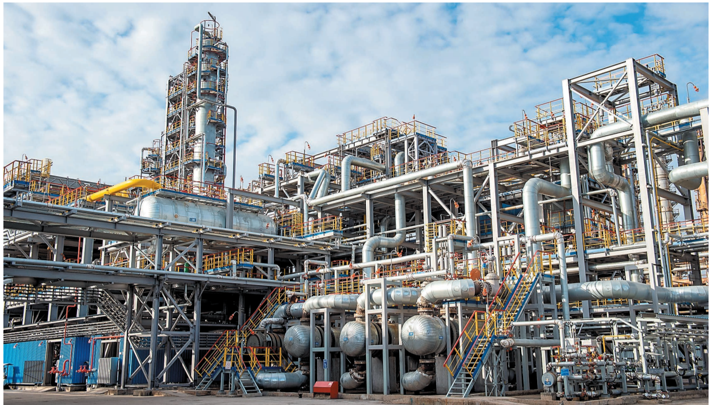
Комплекс каталитического крекинга предназначен для производства высокооктанового компонента автомобильного бензина и сжиженных углеводородных газов – пропан-пропиленовой и бутан-бутиленовой фракций, являющихся ценным сырьем нефтехимии
