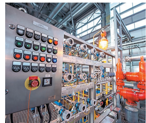
Комплекс оснащен современным оборудованием
