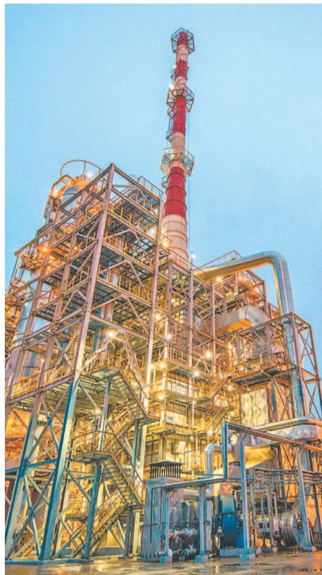
Установка ЭЛОУ АВТ-6 – важнейшее звено в процессе увеличения глубины переработки сырья
