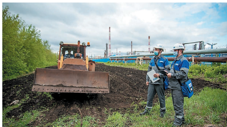
Для исключения риска, связанного с переходом пламени при лесных пожарах на объекты Общества, силами САТ и М проводятся мероприятия по созданию минерализованных полос и опашивание территорий, прилегающих к лесным массивам
