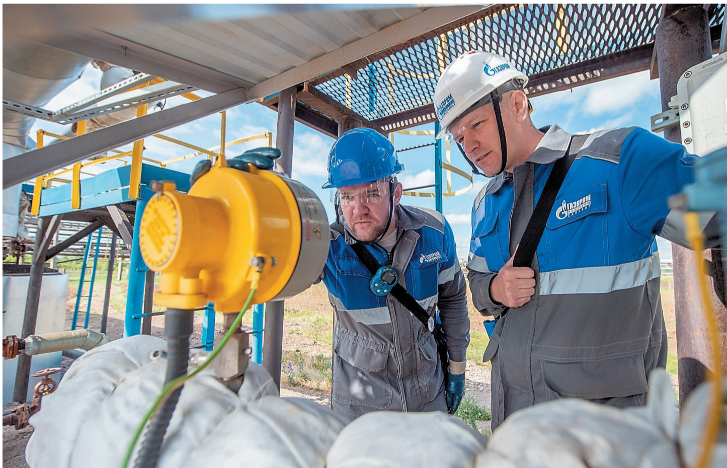
В настоящий момент газофакельная установка завода «Мономер» действует в обычном режиме
