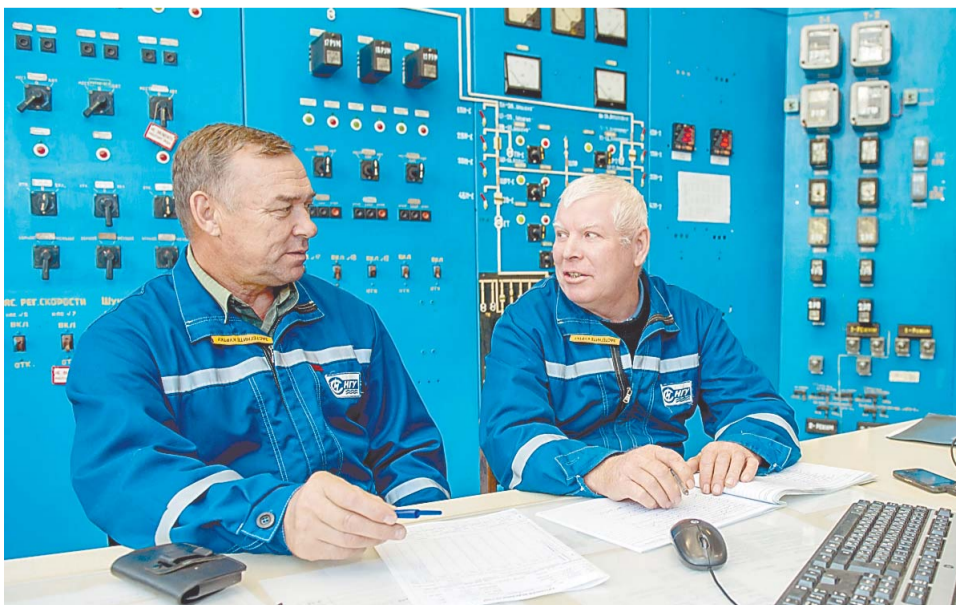
В центральном пункте управления гидроэлектростанции
