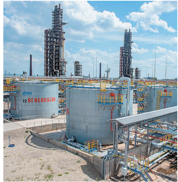
Северный резервуарный парк цеха № 10 НПЗ
