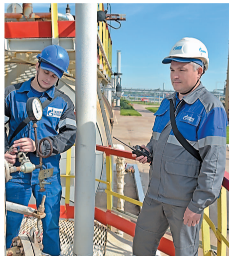
Ежедневный осмотр оборудования
