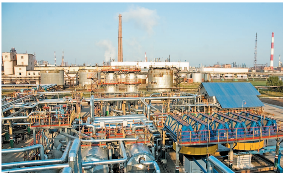
Установка ГО-2 и сейчас – основная мощность по переработке керосино-газойлевой фракции
