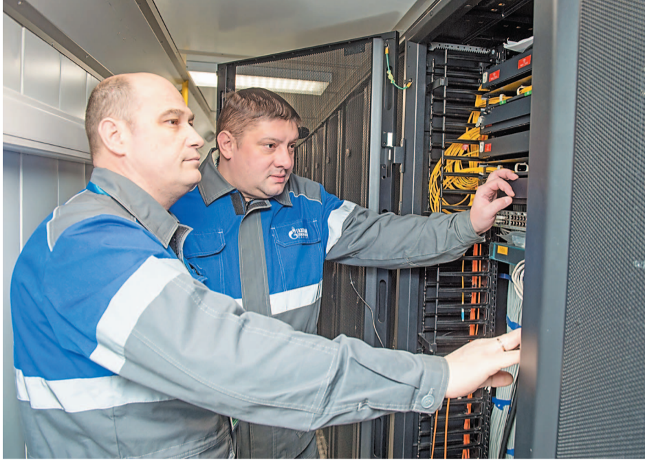
Работу серверного оборудования контролируют сотрудники центра
