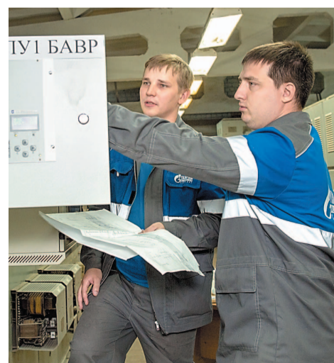
Внедрение цифровых МПУ БАВР обеспечивает непрерывность электроснабжения электроприемников 6 кВ
